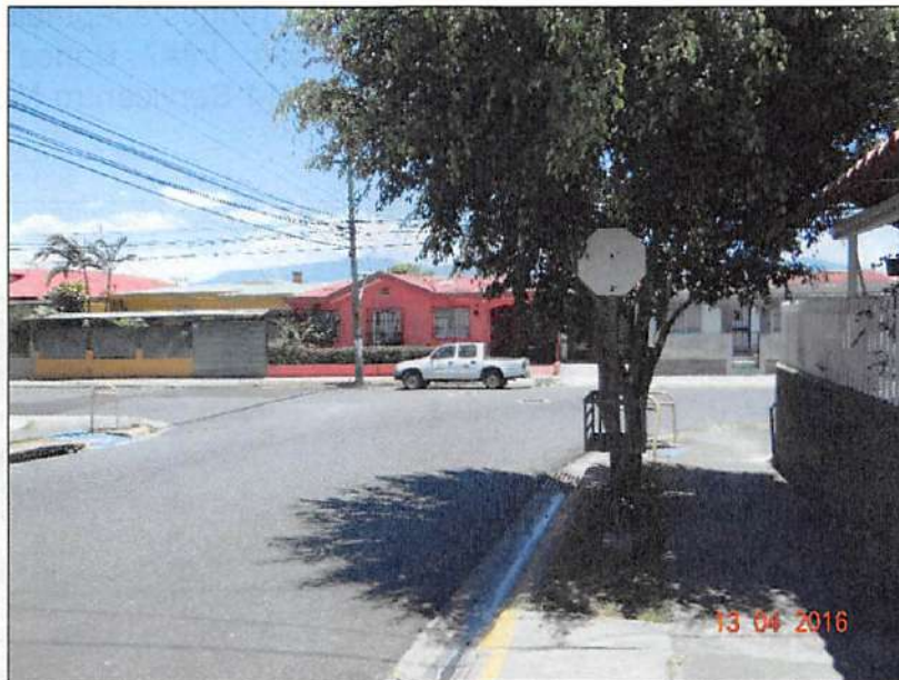
Figura 7 Señalamiento vertical en mal estado y ausencia de señalamiento horizontal, intersección 100 m norte de BAC San José.
